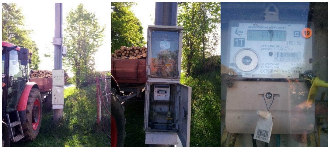
Obrázek 1: Celkový pohled, detail rozvaděče a detail elektroměru
