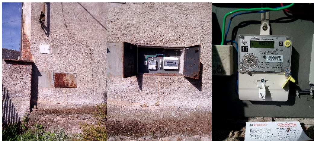
Obrázek 4: Celkový pohled, detail rozvaděče a detail elektroměru
