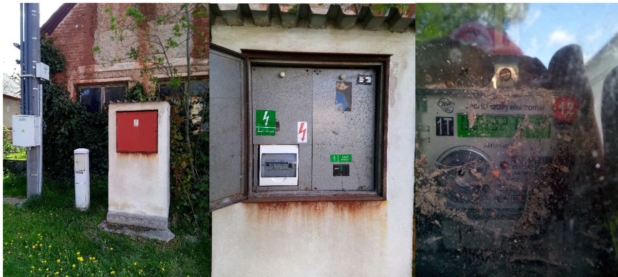
Obrázek 9: Celkový pohled, detail rozvaděče a detail elektroměru
