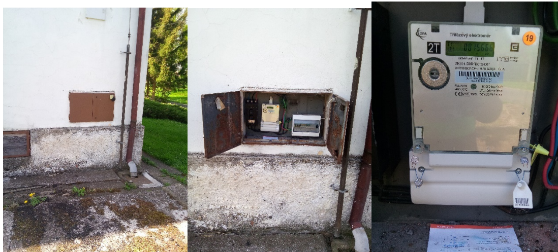
Obrázek 5: Celkový pohled, detail rozvaděče a detail elektroměru
