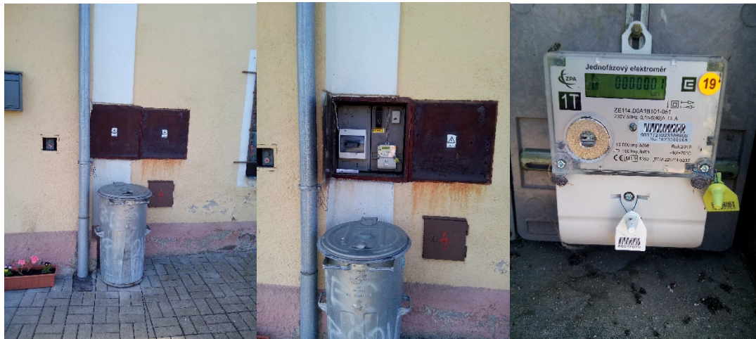
Obrázek 3: Celkový pohled, detail rozvaděče a detail elektroměru
