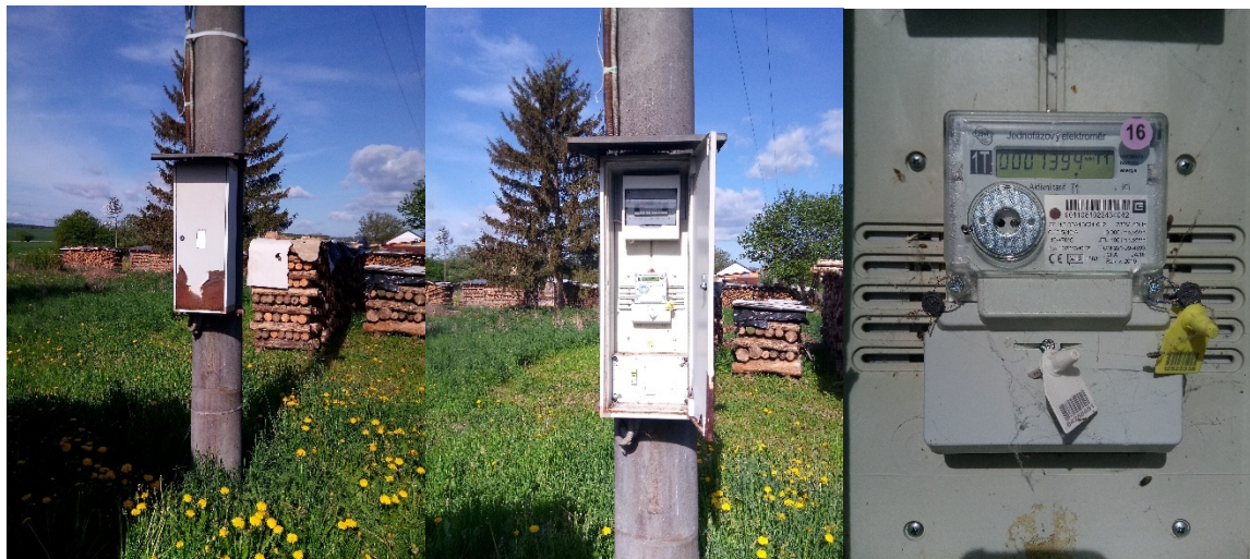
Obrázek 6: Celkový pohled, detail rozvaděče a detail elektroměru
